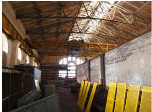
■ Obnova chátrajících budov si žádá investice
